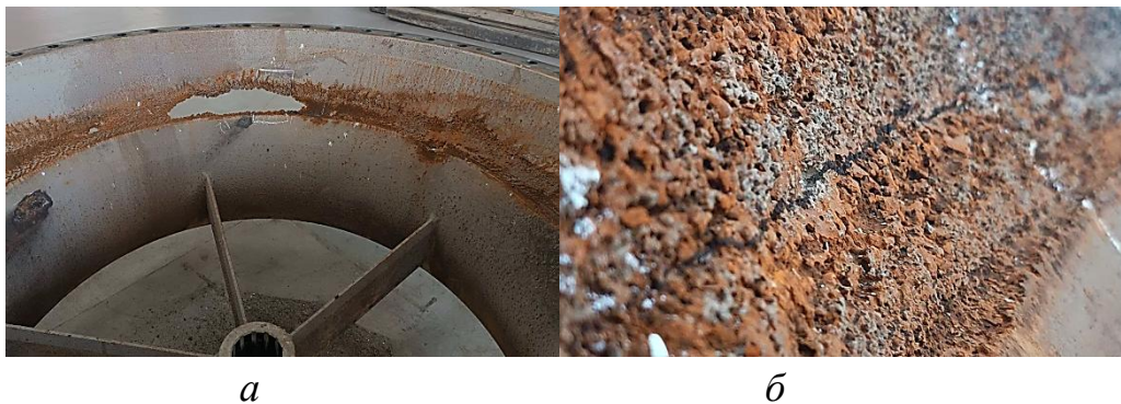
Рисунок 1 – Корозійно-ерозійні руйнування кожуха насосного агрегату
